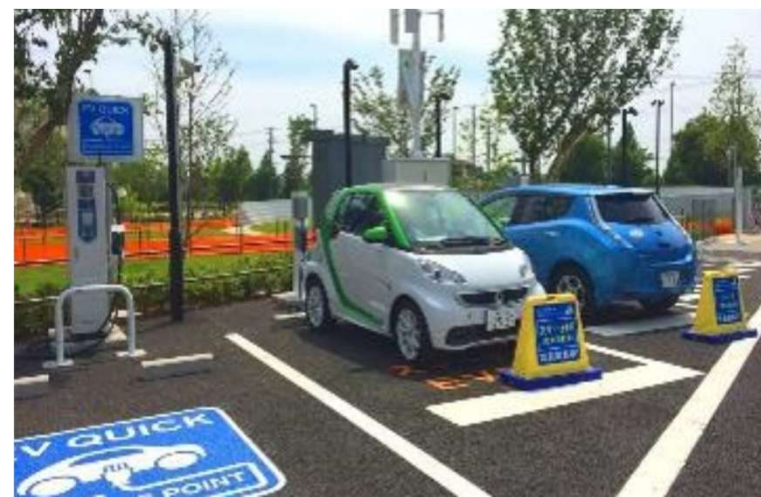
EV充電システム
