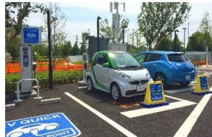
EV充電システム
